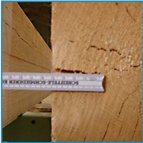
Sparren mit Rissbildung durch vorhandene Markröhre
